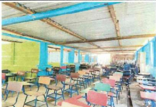
Foto1: Se observa daños en la infraestructura de madera representado un riesgo a los alumnos.
