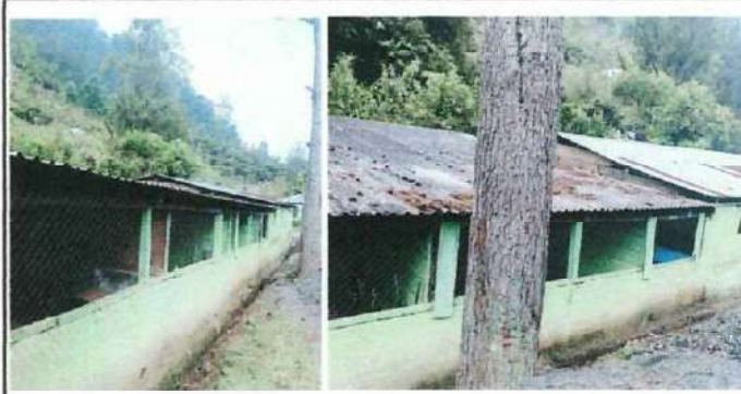
Foto 2: El estado de la lamina se encuentra en malas condiciones por lo que se cambiara el techo por laminas troquelada calibre 26 y la se le dará mantenimiento a las laminas que aun se encuentren en buen estado.
